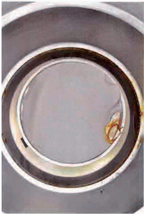
主軸の折損状況（折損部断面）
