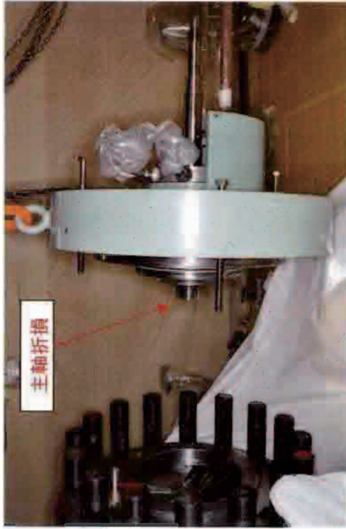
主軸の折損状況
