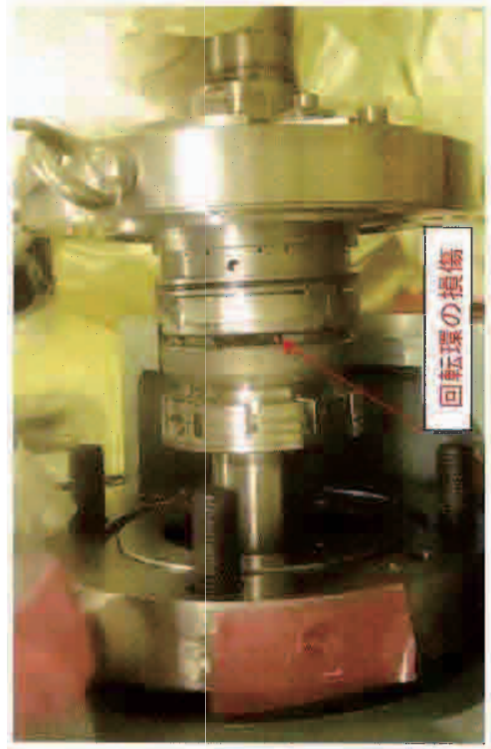
メカニカルシールの損傷状況
