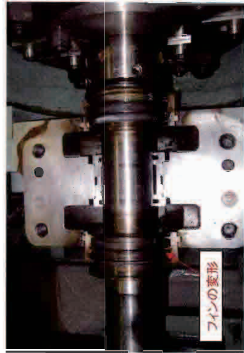
軸受の油切りの変形状況
