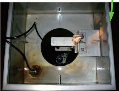
海水ポンプ室への流入口 (循環水ポンプ自動停止用レベル計)
