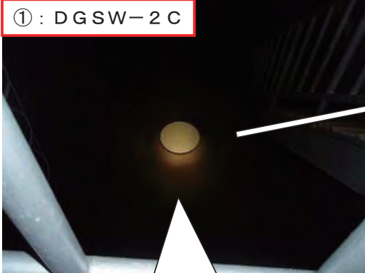
DGSW-2C用電動機上部 天板まで、水没している。
