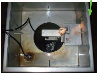
海水ポンプ室への流入口 (循環水ポンプ自動停止用レベル計)
