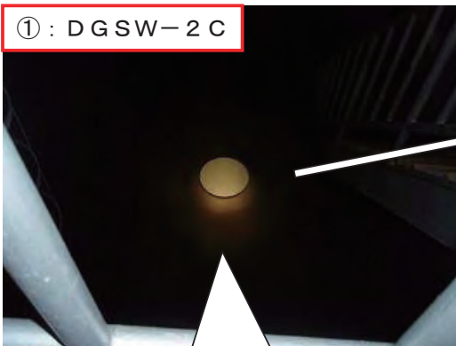
①: DGSW-2C DGSW-2C用電動機上部 天板まで、水没している。
