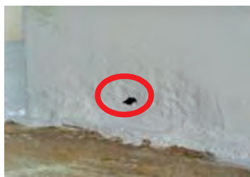
腐食孔を確認(平成20年9月9日) (大きさ:縦約1cm 横約2cm)
